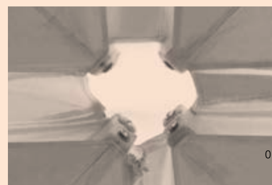
01 | Die Schirme werden an Kränen über dem Fundament positioniert. / The umbrellas are positioned above the slab by crane.
